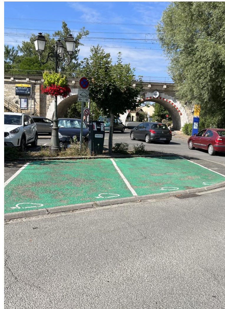
Borne de recharge électrique à Vayres - Crédit image : Iter
